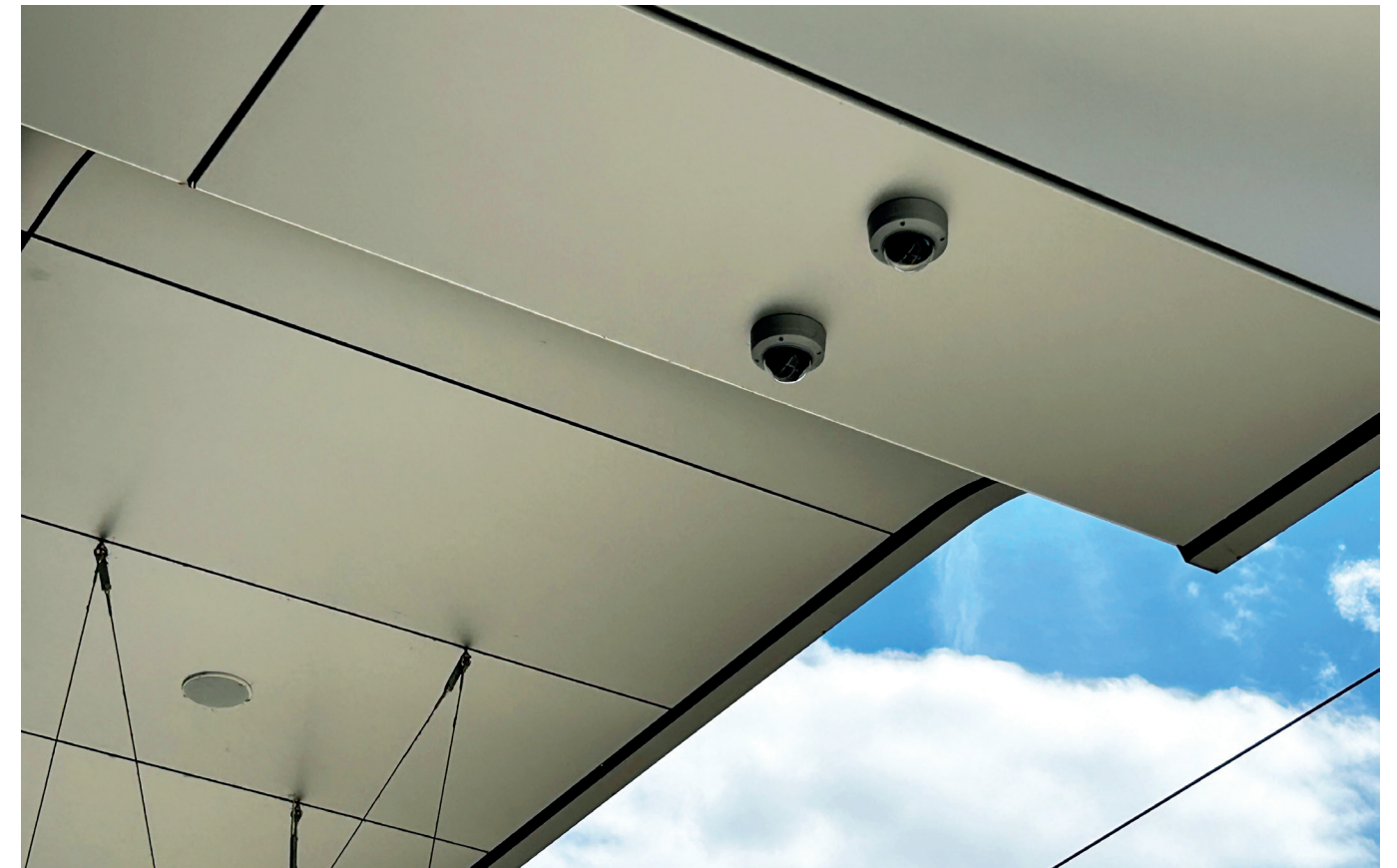
Die Anlagengattung «Niederspannungs- und Telekomanlagen» beinhaltet Niederspannungsverbraucher und übrige Niederspannungs- und Telekomanlagen.
